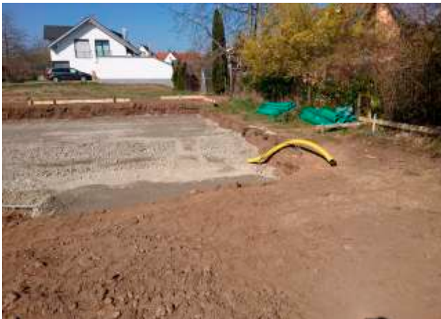
Le fond de fouille est nivelé avec du gravier ou une couche de béton maigre.
