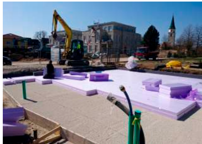
Les panneaux de sol sont parfaitement disposés avec des feuillures en gradin.
