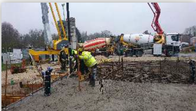
La dalle de plancher est coulée avec du béton prêt à l'emploi
